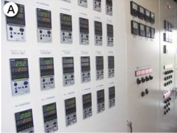
A: 空調設備制御装置 A: Air conditioning systems.
