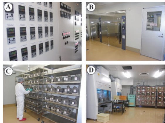
図1. 動物実験施設の設備
