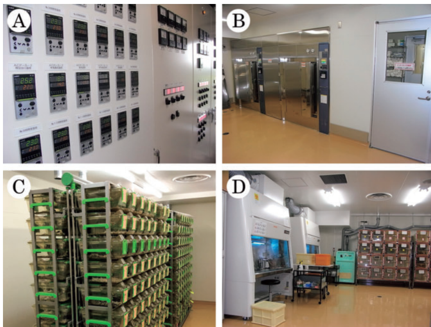
図 1. 動物実験施設の設備 1 A：空調設備制御装置 B：両扉式オートクレープ C：SPF 動物飼育室 D：BSL3/ABSL3 感染実験施設
